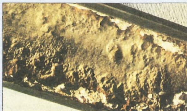
La incrustación en el calentador casi obtura esta tubería de agua caliente. El depósito consiste principalmente en \text{CaCO}_3 con algo de \text{MgCO}_3 .
