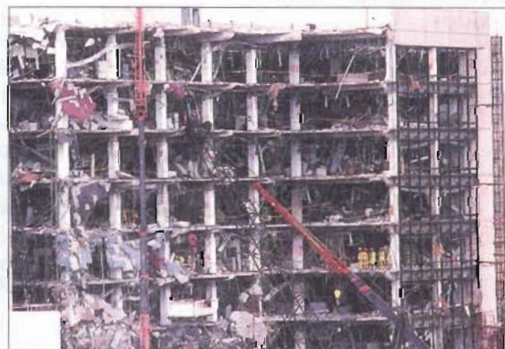
Edificio Alfred P. Murrah después de la fatal explosión causada por una bomba de nitrato de amonio.
